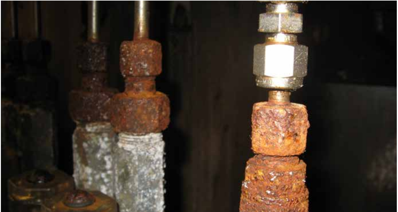
Réaction galvanique créée par des écrous et des tubes en matériaux différents.
